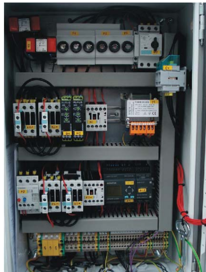
SPS-Steuerung Programmable Logic Controller
