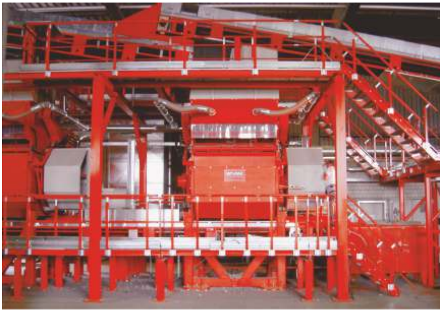
Herzstück der Anlage: der Nachzerkleinerer FineCut.
